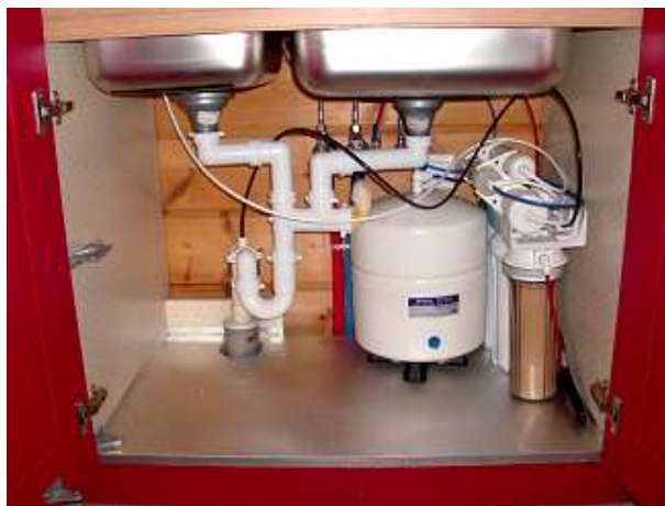
ΣΤΟ ΝΤΟΥΛΑΠΙ ΚΑΤΩ ΑΠΟ ΤΟΝ ΝΕΡΟΧΥΤΗ
