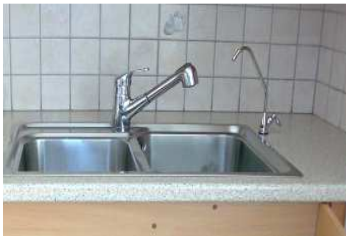
ΒΡΥΣΑΚΙ ΕΠΑΝΩ ΣΤΟΝ ΝΕΡΟΧΥΤΗ (ΔΕΞΙΑ)
