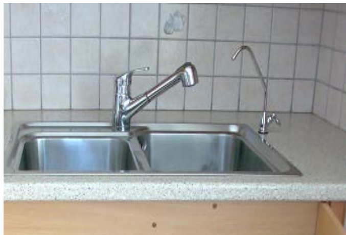
ΒΡΥΣΑΚΙ ΕΠΑΝΩ ΣΤΟΝ ΝΕΡΟΧΥΤΗ (ΔΕΞΙΑ)
