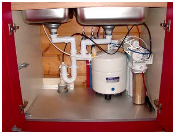
ΣΤΟ ΝΤΟΥΛΑΠΙ ΚΑΤΩ ΑΠΟ ΤΟΝ ΝΕΡΟΧΥΤΗ
